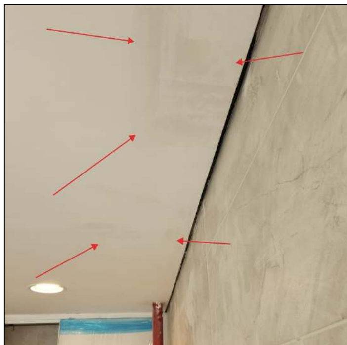
קומה 4 לובי כניסה- תיקוני צבע בכלל התקרה
